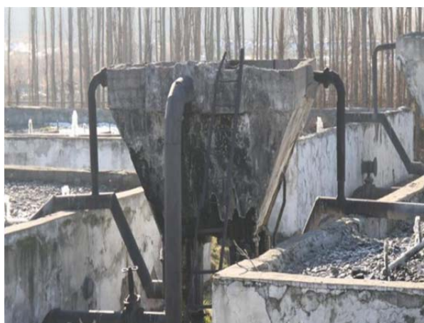
Рис.4. Распределительная чаша очистного сооружения города Джалал-Абад
