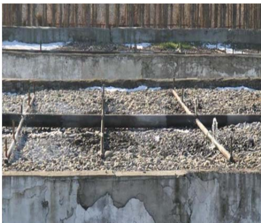
Рис.3. Биофильтры очистного сооружения города Джалал-Абад
