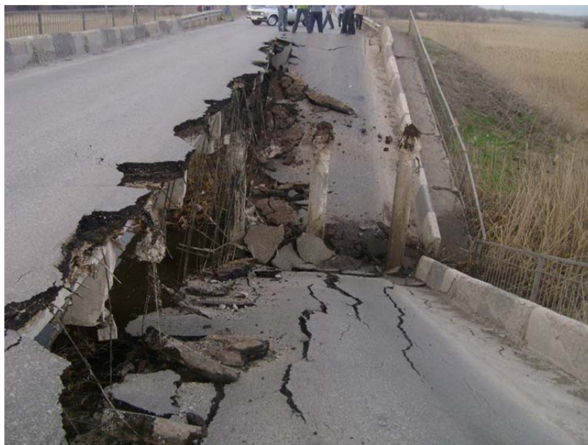
Рис. 4. Аварийное разрушение моста на автомобильной дороге
