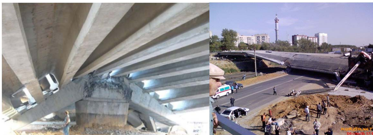
Рис. 2. Аварийное разрушение путепровода
