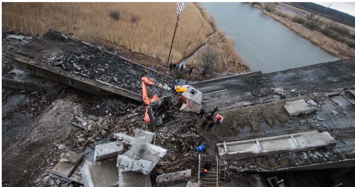
Рис. 3. Аварийное разрушение моста вследствие нарушения порядка очередности проведения демонтажа
