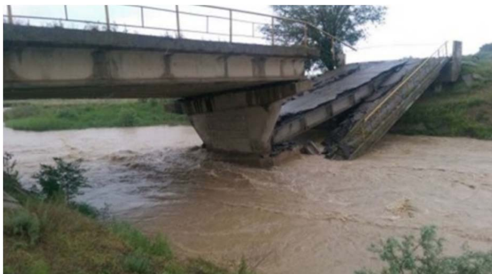
Рис. 5. Аварийное разрушение моста в результате подмыва опоры
